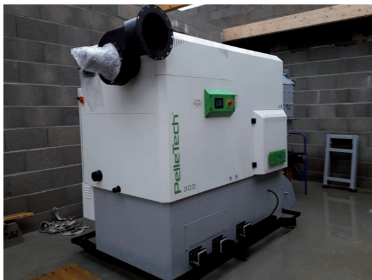
chaudière biomasse installée aux serres municipales
